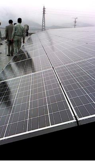
御殿山中学校屋上の太陽光発電パネル
